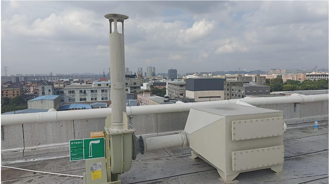
废气废水处理设施照片
