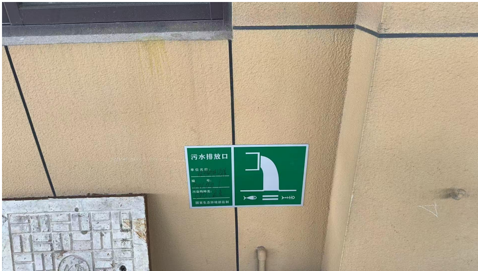
废气废水排放口照片
