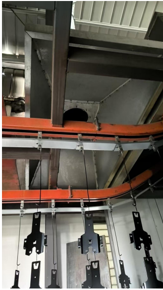
塑粉固化废气收集处理装置
