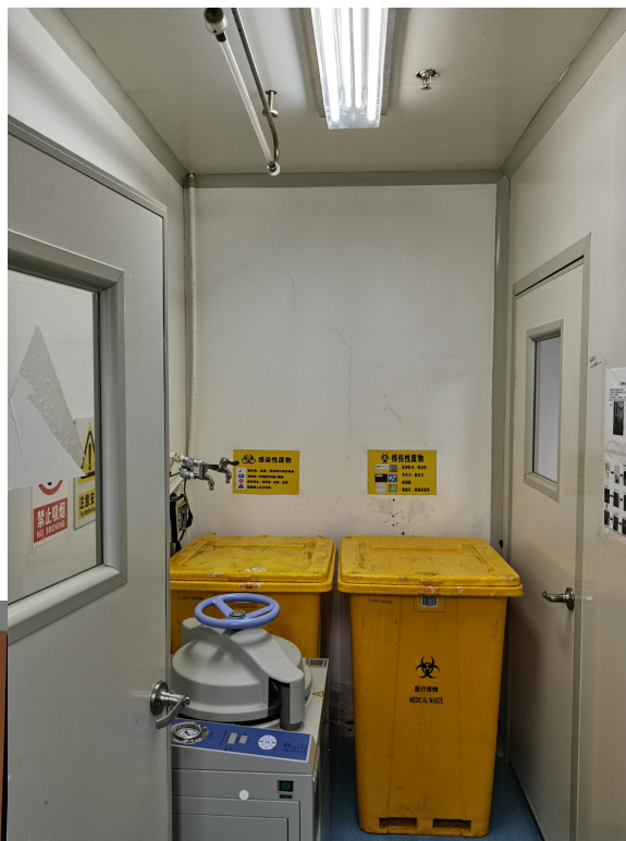
危废车间照片
